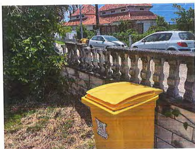
Le mur de séparation avec la rue est en partie endommagé.
